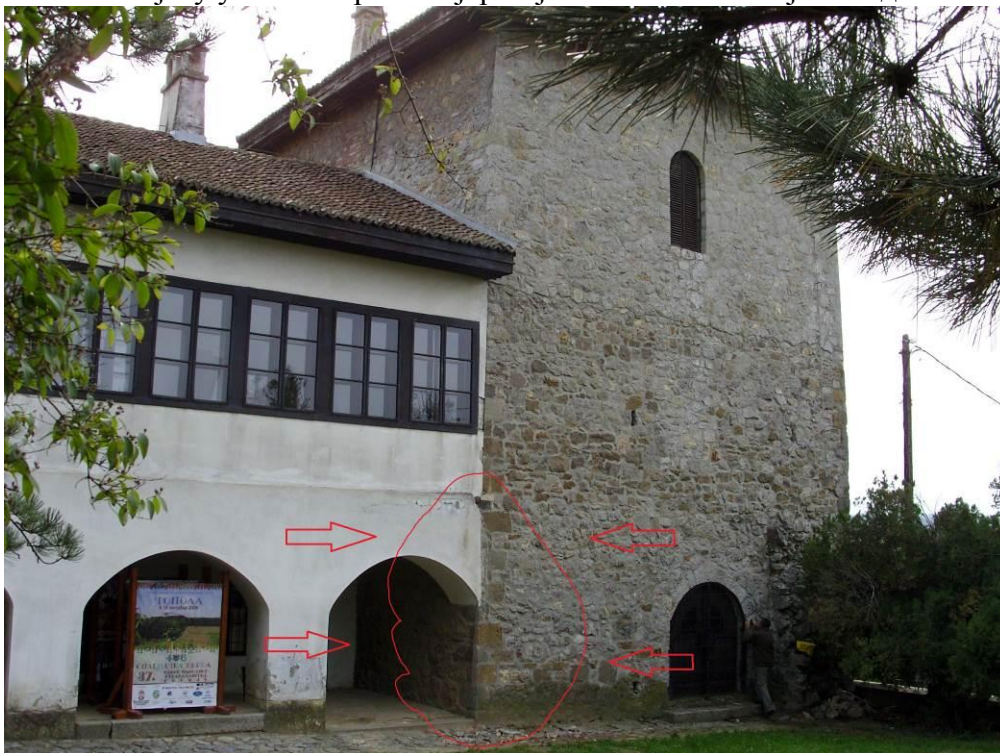
Правац пружања пукотина-предња фасада
